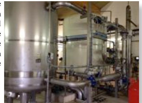
Nouvelle installation, ajout du filtre biologique
